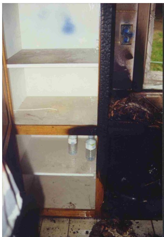
Photo 8 : Absence de dommages dans l'armoire droite
